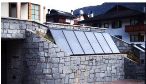
Impianto solare (Tisun)
