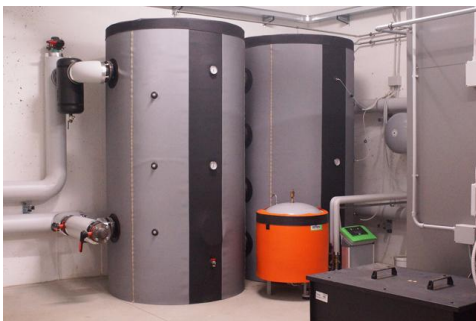
Impianto di riscaldamento (Dettaglio 1)
