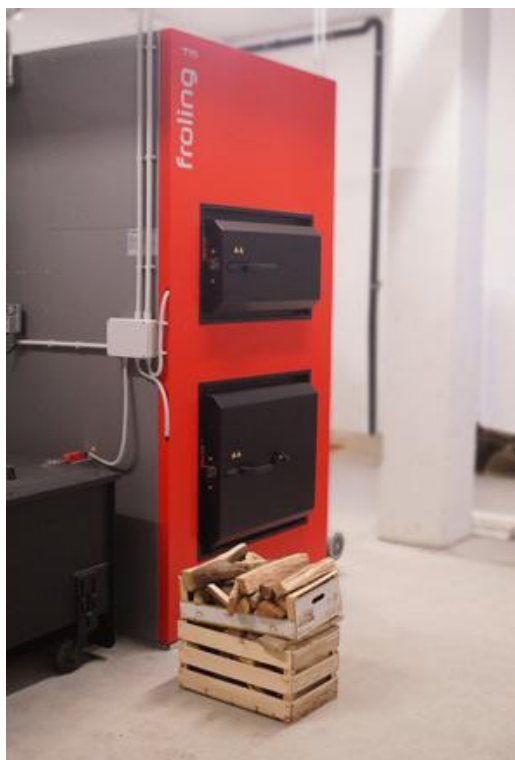
Impianto di riscaldamento (Dettaglio 2)
