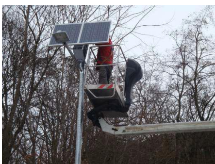
ILLUMINAZIONE FOTOVOLTAICA PUBBLICA A LED E ACCUMULATORI - (TN) TRENTO
