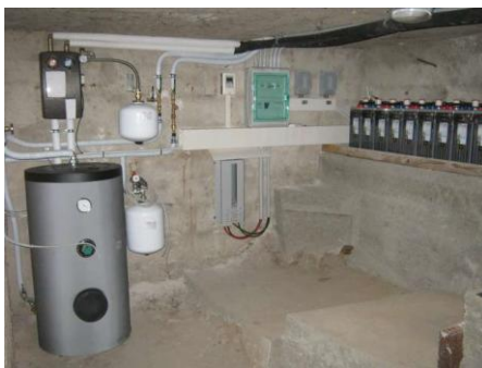
CENTRALE FOTOVOLTAICA-TERMICO SANITARIA PER CASA ISOLATA - LOCALITA' TRASIEL (TN)
